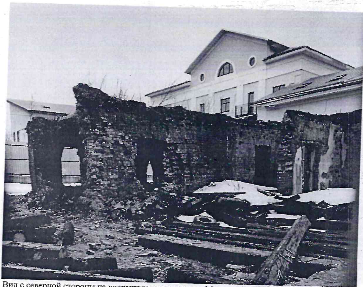
Вид с северной стороны на восточную часть здания. Восточная капитальная стена здания полностью утрачена.
